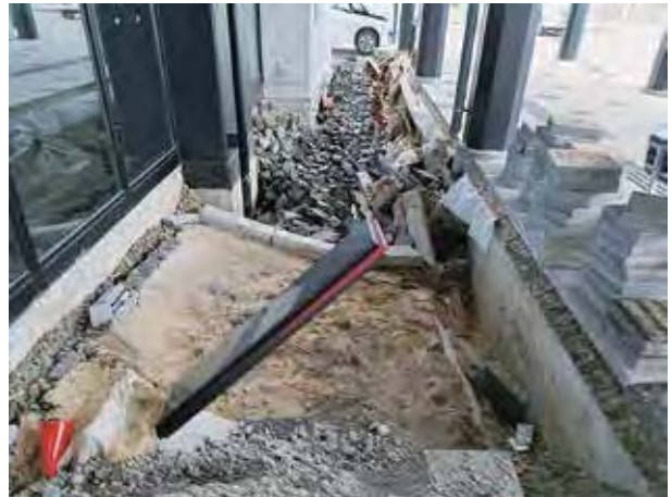
輪島市役所 地震被害
